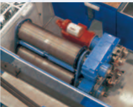
2 cabrestantes de elevación en la grúa Gottwald con cuchara de 4 cables
